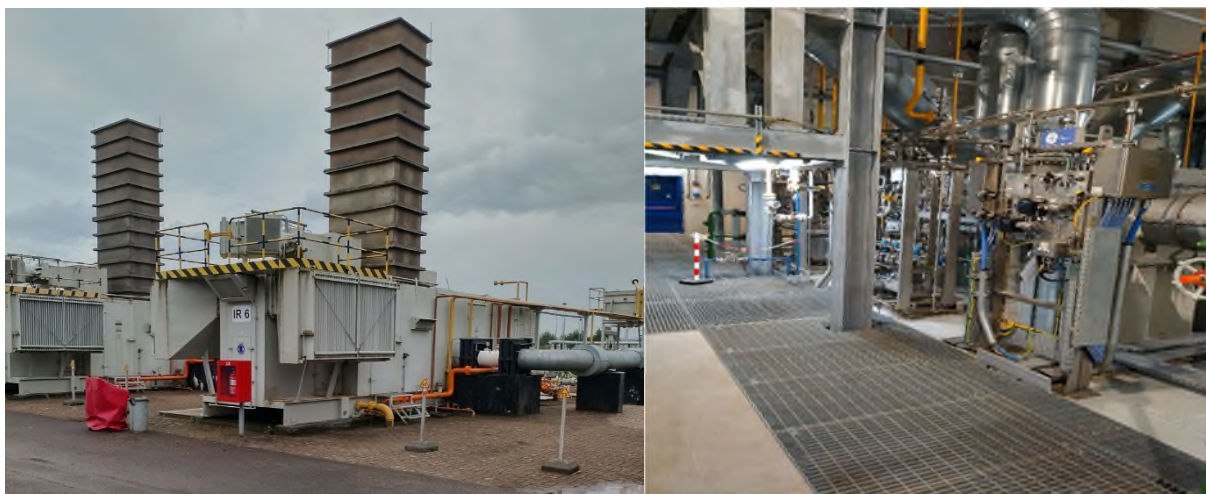
Figure 24 : Turbocompresseur (à gauche – IR6) et compresseur électrique (à droite – GE9) –(Source : Sertius)
