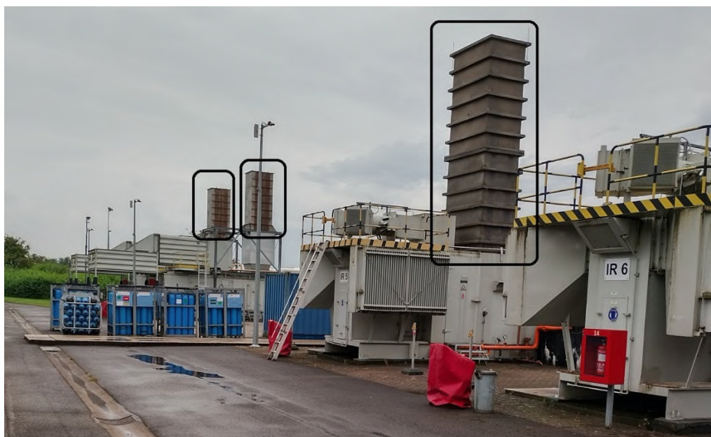
Figure 35 : Cheminées d'évacuation au niveau des turbines – voir encarts noirs (source : Sertius).
